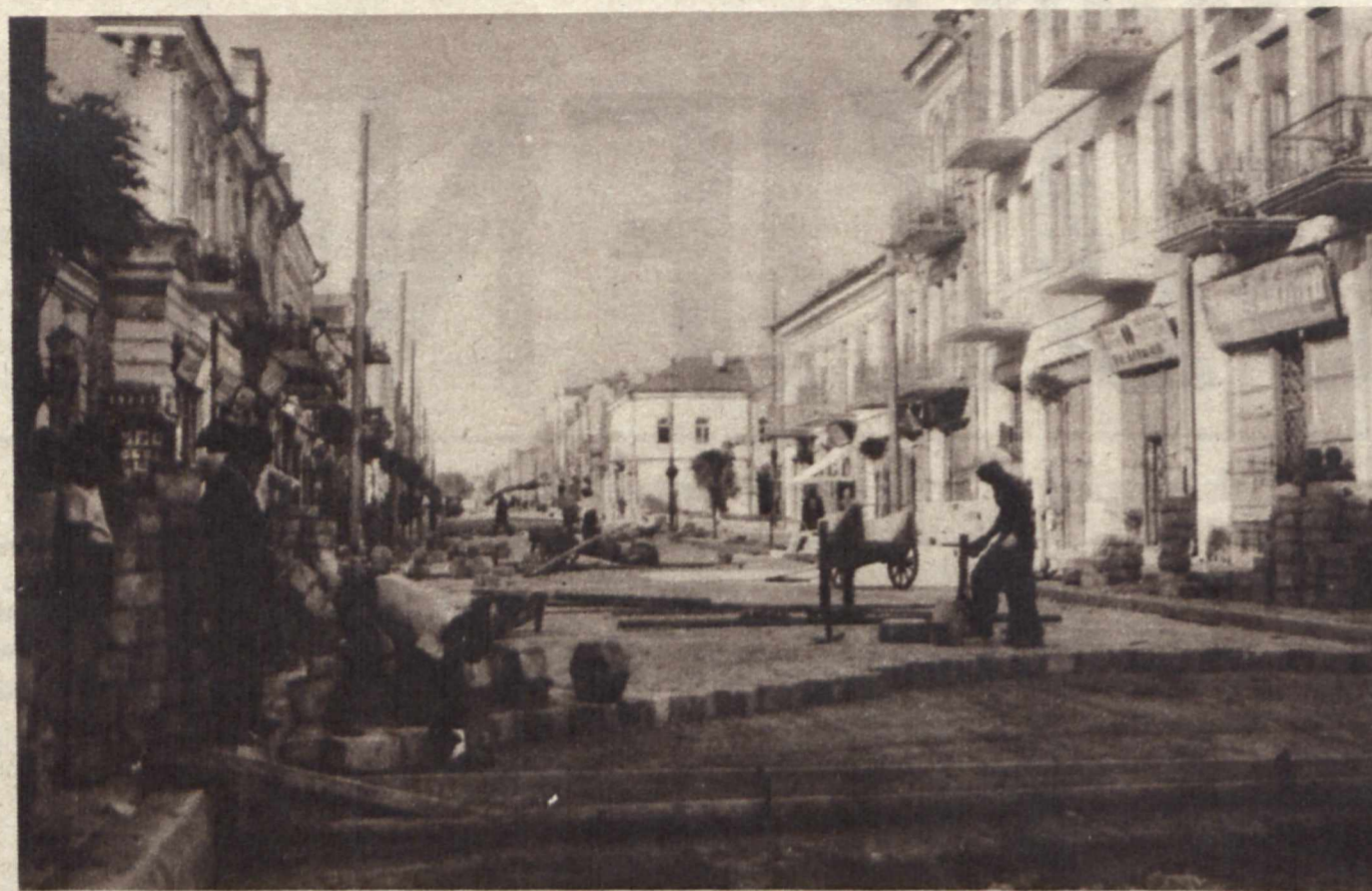
WOŁYŃ EUROPEIZUJE SIĘ. W Równem, w Łucku i w innych miastach Wołynia Zarządy Miejskie przystąpiły do układania na głównych ulicach kostki systemu inż. Trylińskiego. Zdjęcie przedstawia układanie kostki tego systemu na jezdni m. Łucka na ul. Jagiellońskiej.
