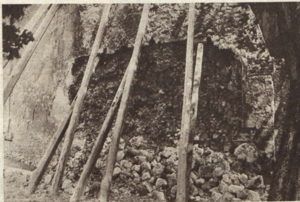
Zawalenie się ściany w Muzeum Etnograficznym w Krakowie. Skutkiem długotrwałych deszczów osunęła się ściana starego budynku Muzeum Etnograficznego na wzgórzu wawelskim i musiano ją na razie podeprzeć belkami.
